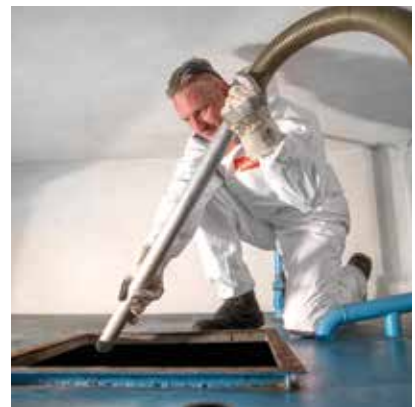
Eine Tankreinigung kann auch mit vollem Öltank durchgeführt werden.
