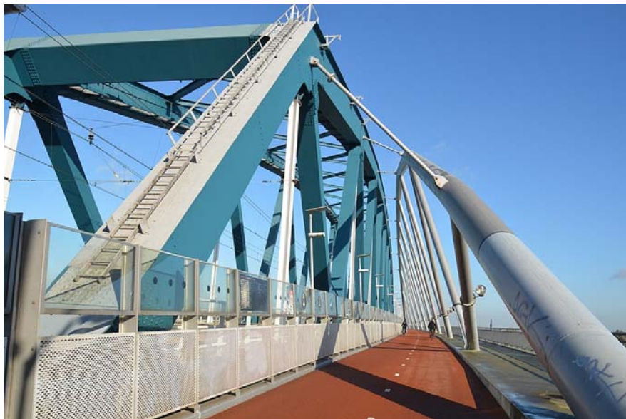
Abbildung 90: Nachträglich an eine bestehende Eisenbahnbrücke angebauter Radweg, Beispiel aus Nijmegen, Niederlande (Snelbinder).
